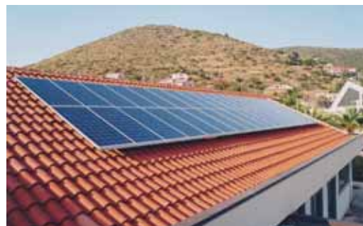
Comune di Castellabate (Sa) - complesso scolastico Programma Tetti Fotovoltaici "Bando Nazionale"
