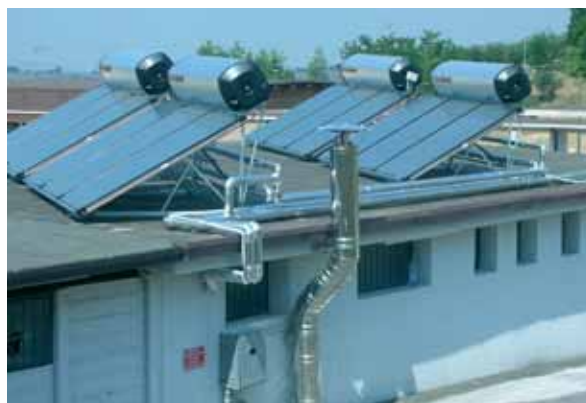
Impianto solare termico installato presso il Comune di Monte San Pietrangeli
