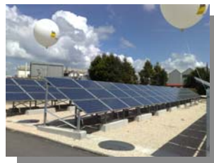
Impianto a Nettuno Roma
